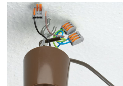
Connexion des luminaires avec câble flexible
